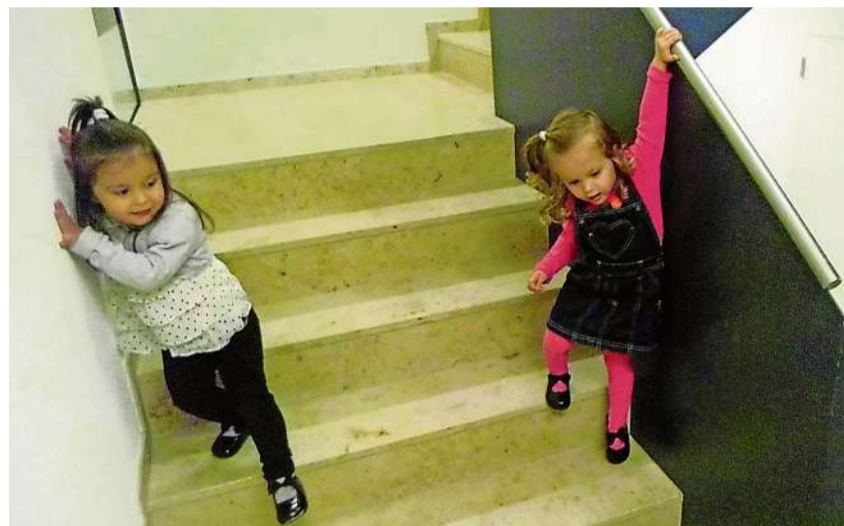
In einem Wohnhaus in Seen: Auch hier müsste beidseitig ein Handlauf sein.
