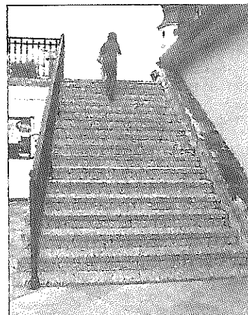
Kremser Richter befand: An der Treppe fehlt ein zweiter Handlauf.
