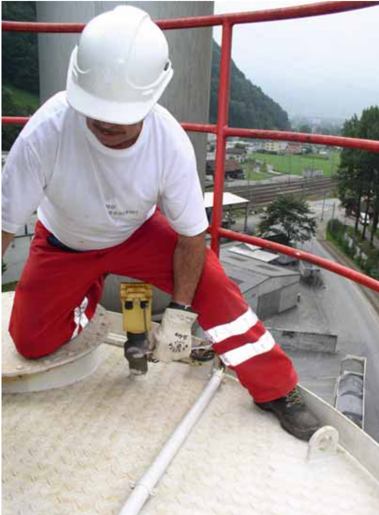
Bild 19 Die Fussleiste von mindestens 100 mm Höhe verhindert, dass Personen bei Wartungsarbeiten unter dem Geländer wegrutschen oder dass Gegenstände hinunterfallen und Personen gefährden.
