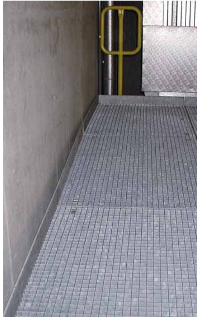
Bild 8 Fussleiste zur Sicherung der maschinen- bzw. wandseitigen Absturzkante. Die Fussleiste ist erforderlich, weil der horizontale Abstand der Laufebene zur Wand bzw. zur Maschinenverkleidung mehr als 30 mm beträgt. Im Bereich des Hintergrunds, wo der Abstand 200 mm überschreitet, wurde ein Geländersegment angebracht.
