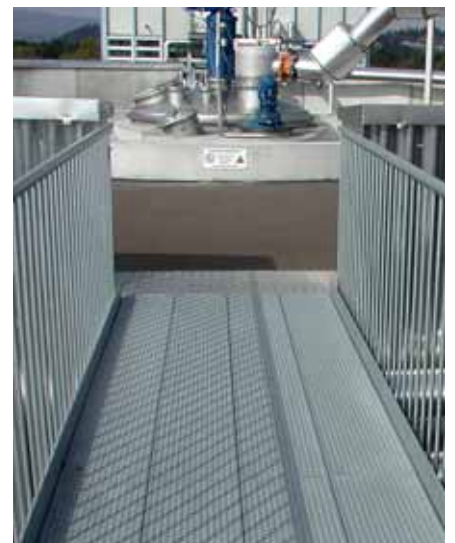
Bild 18 Geländer mit vertikalen Füllstäben. Der Abstand der Stäbe (lichte Weite) beträgt nicht mehr als 180 mm.
