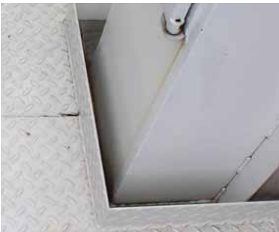
Bild 9 Fussleiste um eine Bodenöffnung, deren horizontaler Abstand zur Säule mehr als 30 mm beträgt.
