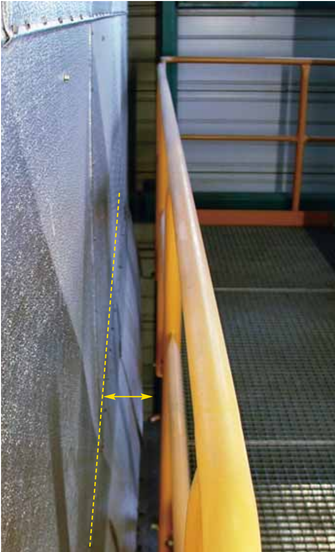
Bild 7 Geländer zur Sicherung der maschinen- bzw. wandseitigen Absturzkante. Das Geländer ist erforderlich, weil der Abstand der Laufebene zur seitlichen Maschinenverkleidung bzw. zur Wand mehr als 200 mm beträgt.
