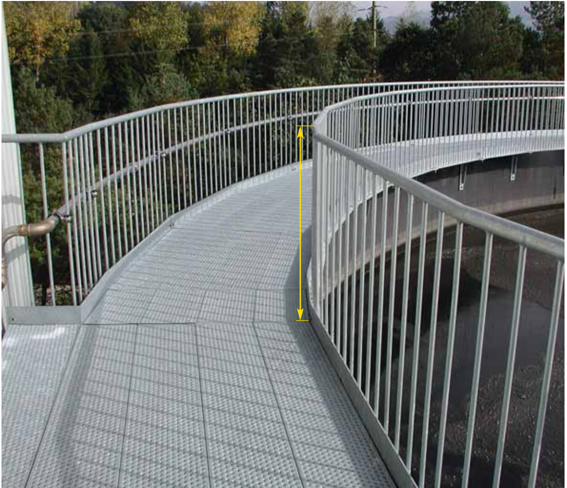
Bild 10 Die Geländerhöhe beträgt 1,1 m – von der Lafebene zur Oberkante des Handlaufs gemessen.
